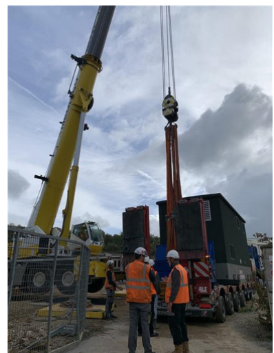
Livraison du poste de livraison
